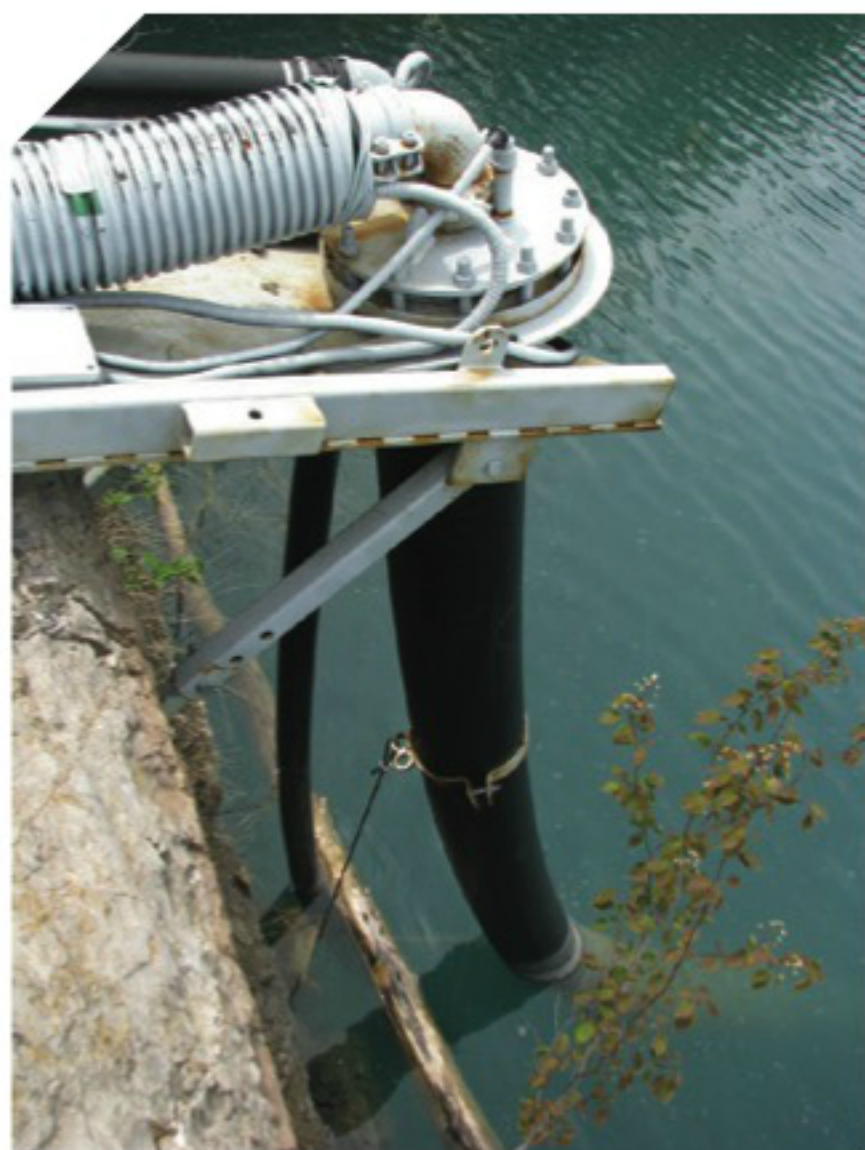
Ancrage à la falaise d'un conduit principal.
