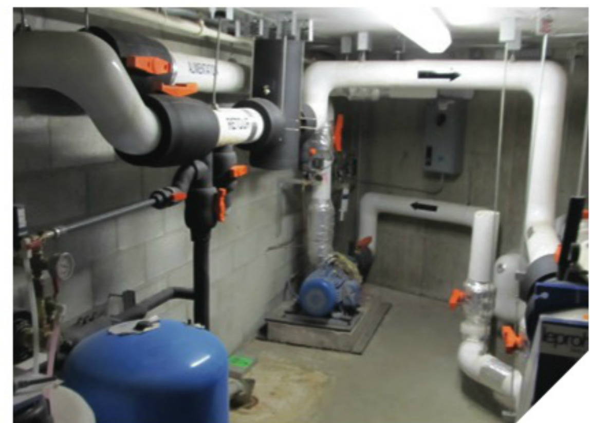
L'une des salles mécaniques.
